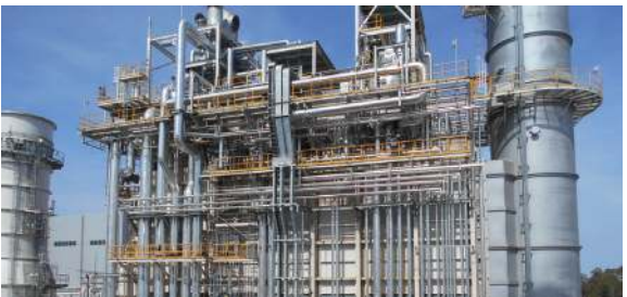
Planta de ciclo combinado | Hyundai Piping Año: 2015
