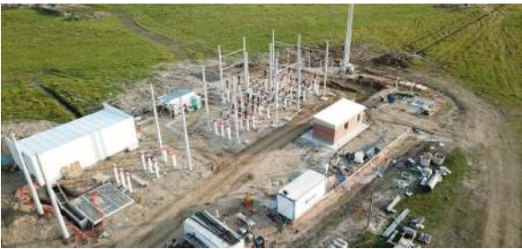
Subestación y tendido | Cielo Azul Montaje de Estación Año: 2019
