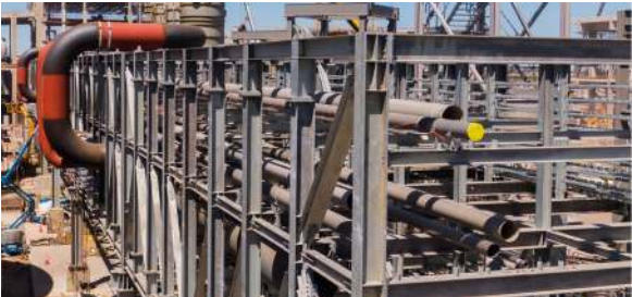
Heat Tracing | UPM II Montaje Eléctrico Año: 2023
