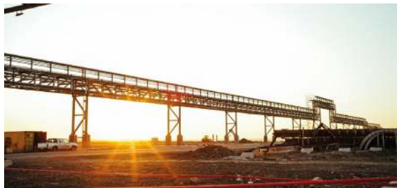
Pipe Bridges | UPM II Piping Año: 2022
