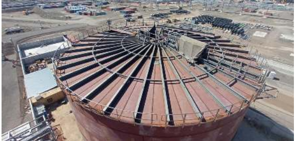
Tanques | UPM II Tanques Año: 2022
